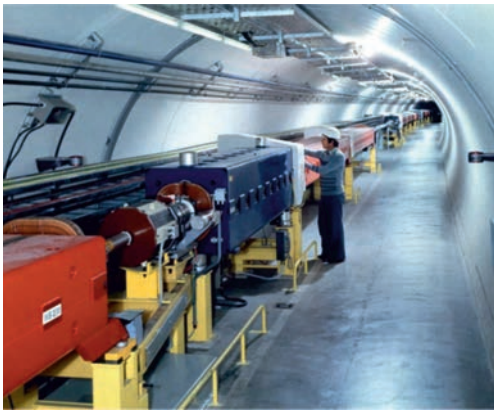
Рис. 7.12. Магнитные элементы внутри SPS в туннеле, в котором расположен ускоритель
